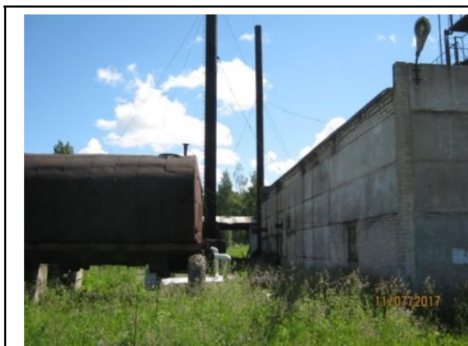
Рисунок 1.2.1. – Здание и баки котельной № 1
